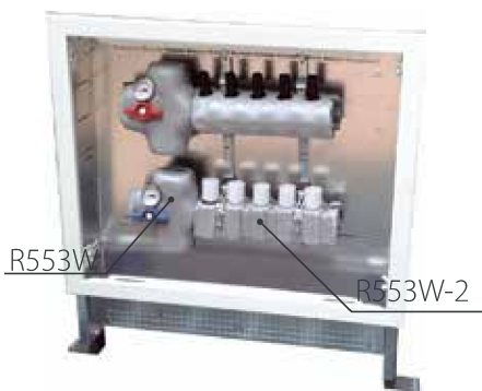
Установленный в шкаф коллектор с теплоизолирующими оболочками.
