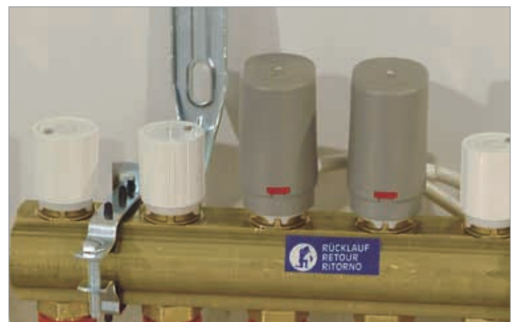
Рисунок 9. Электротермические сервоприводы, установленные на коллектор.
